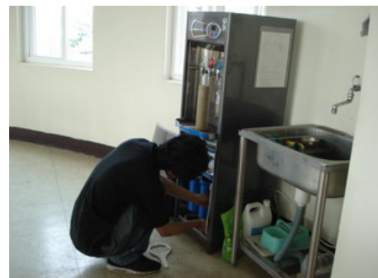
飲用水設備定期檢查維護
